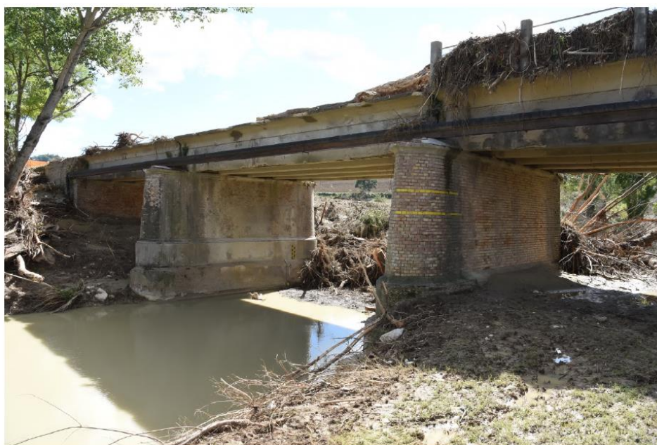
Figura 24 – Danneggiamento di ponte sul fiume Nevola (affluente del fiume Misa) ed ostruzione per trasporto solido
